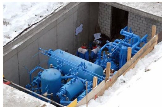
Die am Ufer des St. Moritzersees im Boden eingelassene Fassungs- und Wärmepumpanlage (Bild: ewz).
