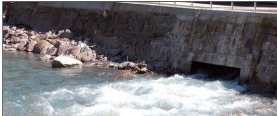
Doppelpower: das Wasser wird ein zweites Mal für die Energiegewinnung genutzt (Bild: ehuber)
